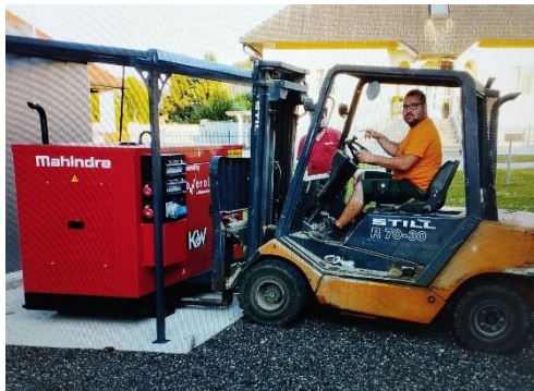
Juli 2024 – Platzierung Notstromaggregat
