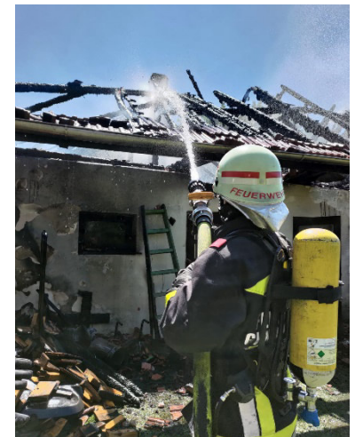
Mai 2022 – Dachbrand Fahndorf
